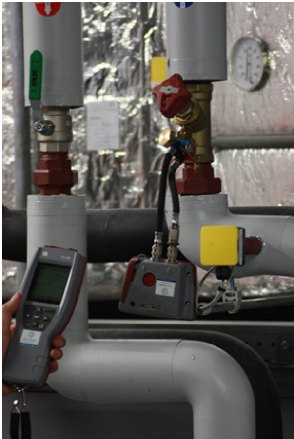
Afb. 9.53 Inregelafsluiter (afsluiter met rode handbediening)
