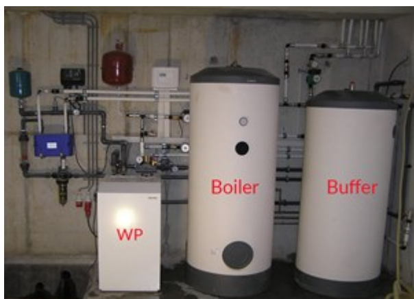
Afb. 9.64 Buffervat naast tapwaterboiler en warmtepomp
