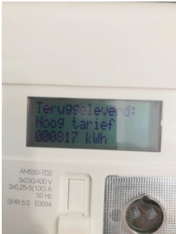
Afb. 15.9 Teruglevering van zonnestroom aan het elektriciteitsnetwerk
