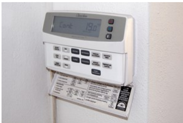
Afb. 9.77 Klokthermostaat (centrale regeling)
