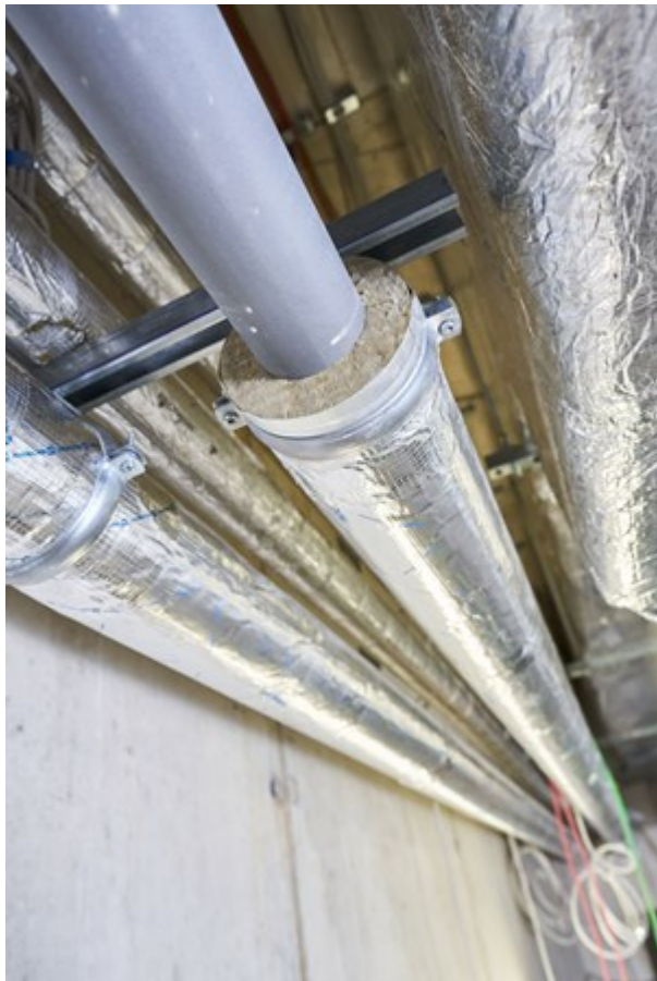
Afb. 9.56 Isolatie leidingen verwarming
