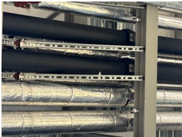
Afb. 9.57 Isolatie leidingen verwarming (linker twee leidingen)
