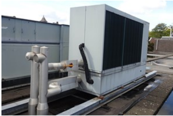
Afb. 10.15 Compressiekoelmachine met distributieleidingen
